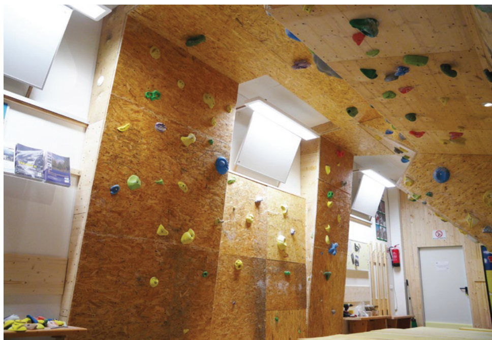
Boulderhalle des Alpenvereines: Behagliche Wärme durch funktionelle Infrarot-Heizung
